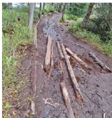
Exemples représentant le mauvais état des sentiers.
